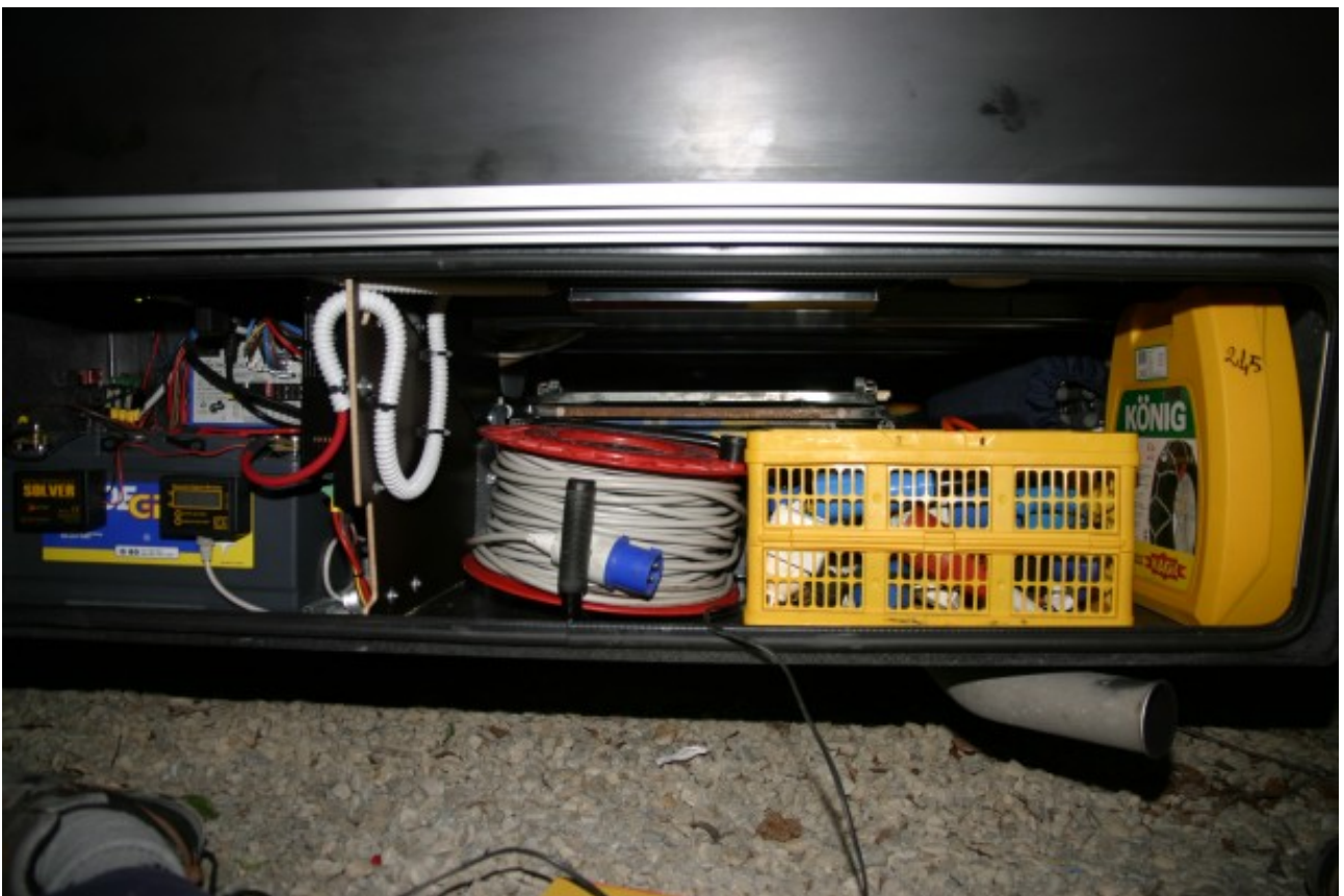
il gavone con il suo contenuto, l'inverter non interferisce con l'uso del gavone
