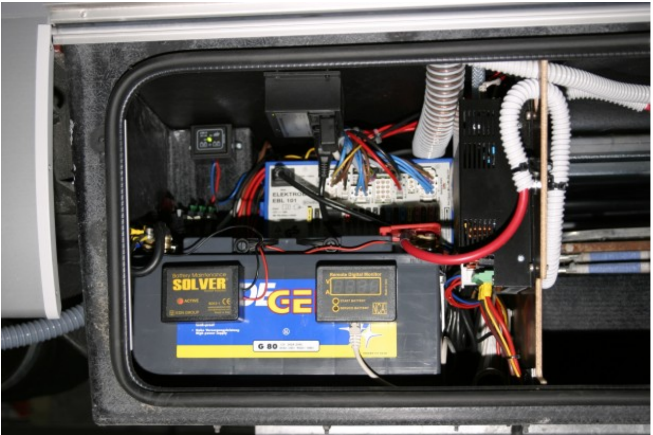
la batteria con i grossi cavi dell'inverter protetti da guaina
