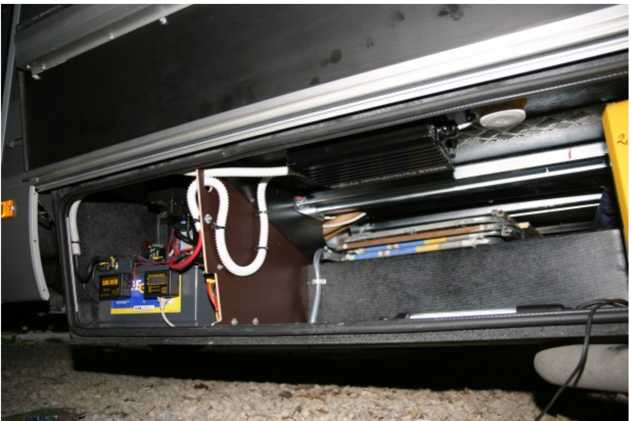
vista dell'inverter, batteria e cavi
