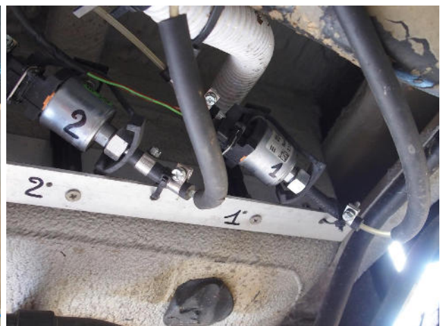
le due pompe gasolio sotto al pianale
